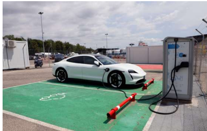
Cargador para vehículos eléctricos
