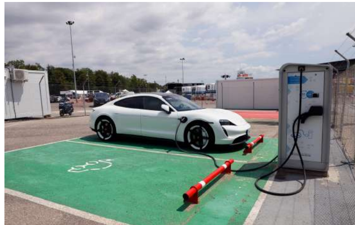
Cargador para vehículos eléctricos
