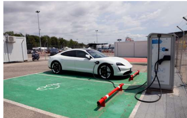
Carregador per vehicles elèctrics
